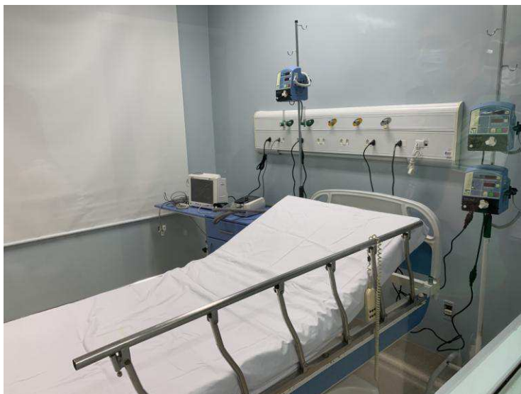
Leito de UTI: Sem conexões do ventilador, sem umidificador e sem equipamento de aspiração
